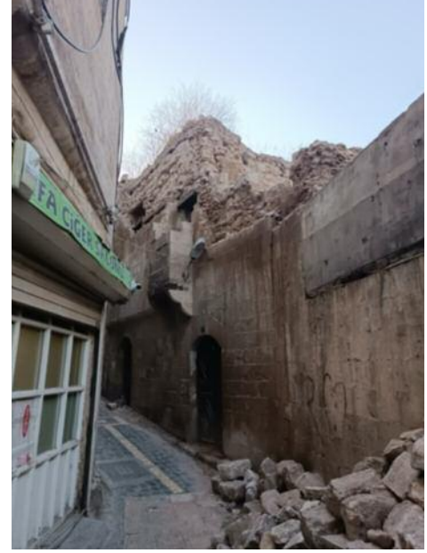
■ Görsel 18b: Duvarları Sokağa Yıkılan Ev (2)
