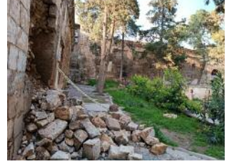
■ Görsel 2d: Hazireye Doğru Yıkılan Duvarlar
