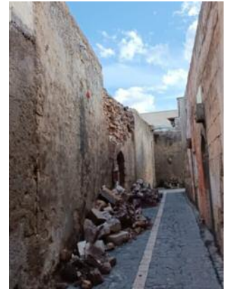
■ Görsel 19c: Kemerli Yapıda Görülen Hasar
